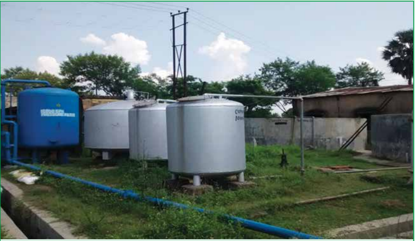
प्रेसर फिल्टर प्लांट, झांजरा (क्षमता 32000 जीपीएच)
